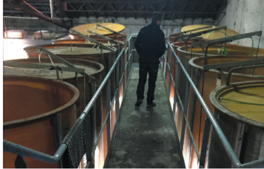
Protection permanente d'une passerelle de visite
